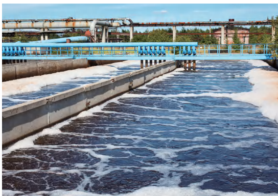
Очистка сточных вод
