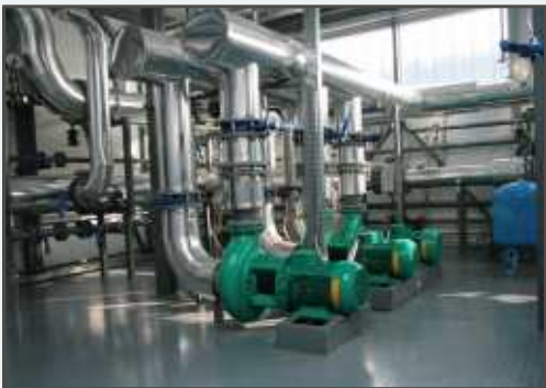
ОВК и водоснабжение
