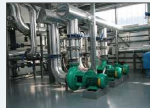
ОВК и водоснабжение
