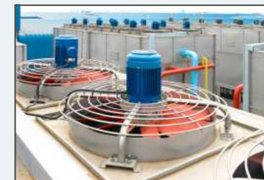
Вентиляторы и насосы
